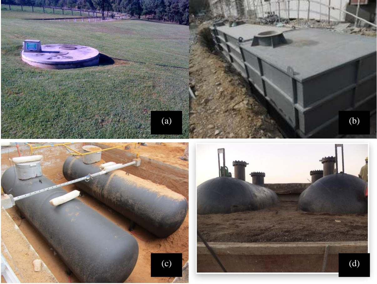
Şekil 15. (a) Gömülü tank (b) su tankı (c) ve (d) yakıt depolama tankları
