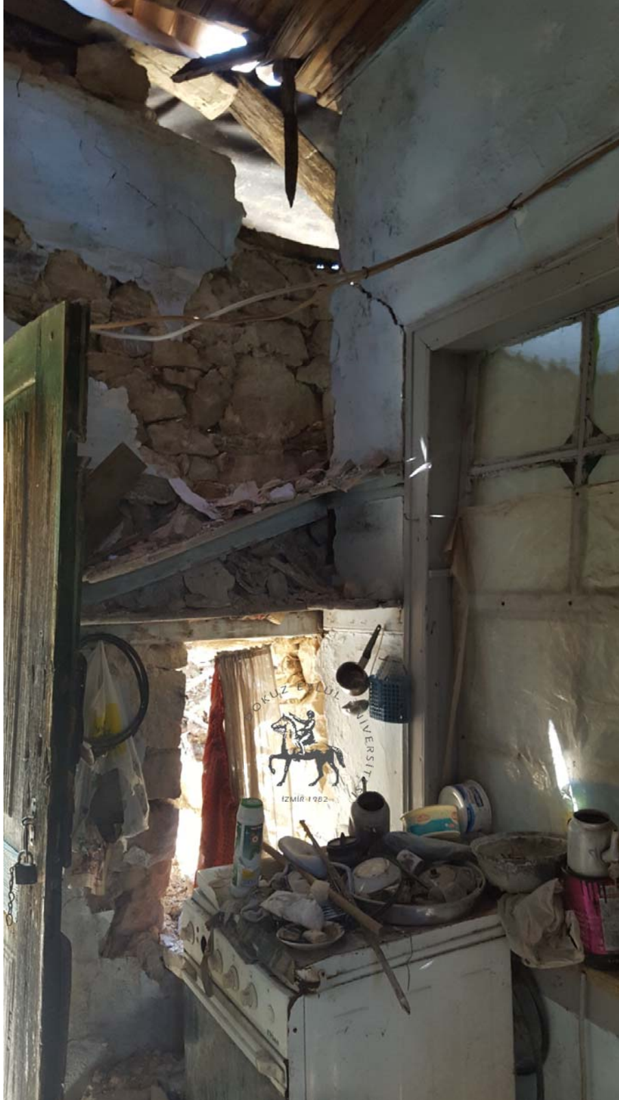
Foto 4. Kösedere'deki eski yığma (kerpiç) yapıda oluşan kısmi duvar yıkılması ve çatlağın görünümü
