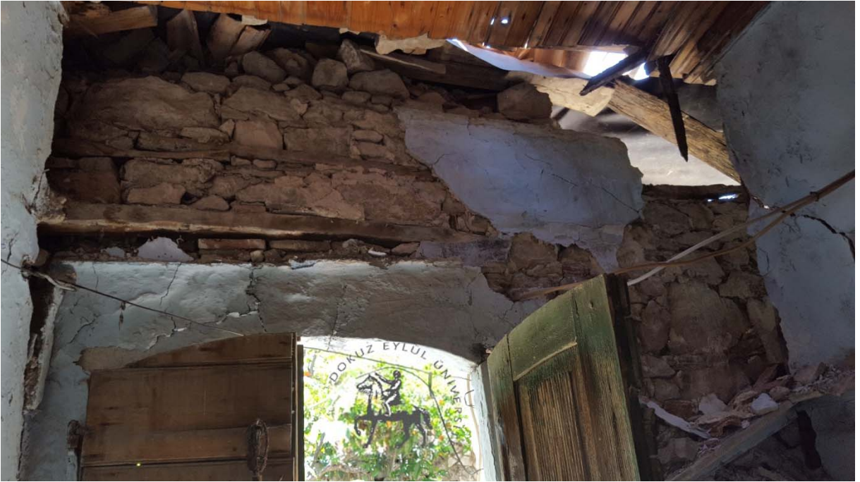
Foto 6. Kösedere'deki eski yığma (kerpiç) yapının duvarında oluşan kısmi yıkılma ve sıva düşmesi, duvardaki çatlak ile tavadaki ahşap döşeme kirişinde oluşan ayrılmanın görünümü
