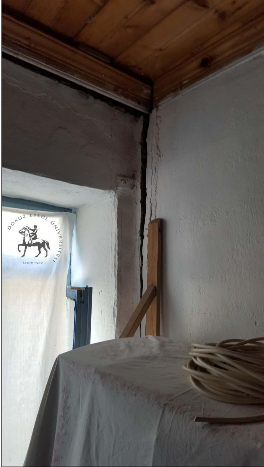
Foto 1: Bozköy'de hasar gören iki katlı yığma (kerpiç) yapının üst kat odasının dış cepheye bakan köşesinde ve tavan kaplaması arasında oluşan derin çatlığın görünümü
