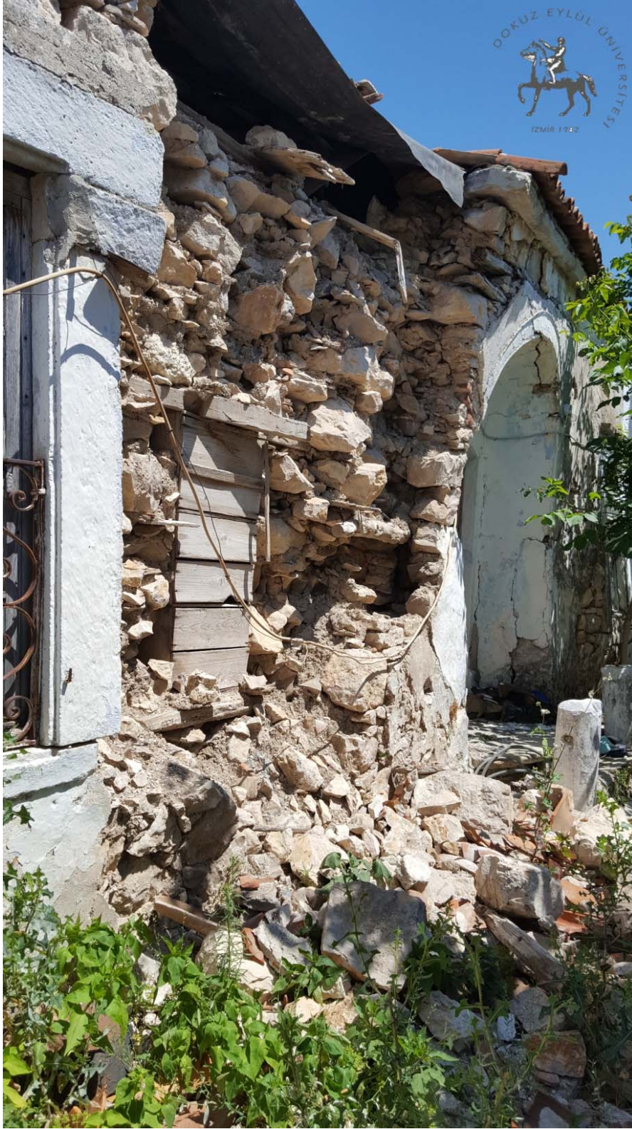
Foto 3. Kösedere köyünde yığma taş yapıda duvar yıkılması ve yapı girişindeki kemerin üzerinde oluşan çatlakın görünümü
