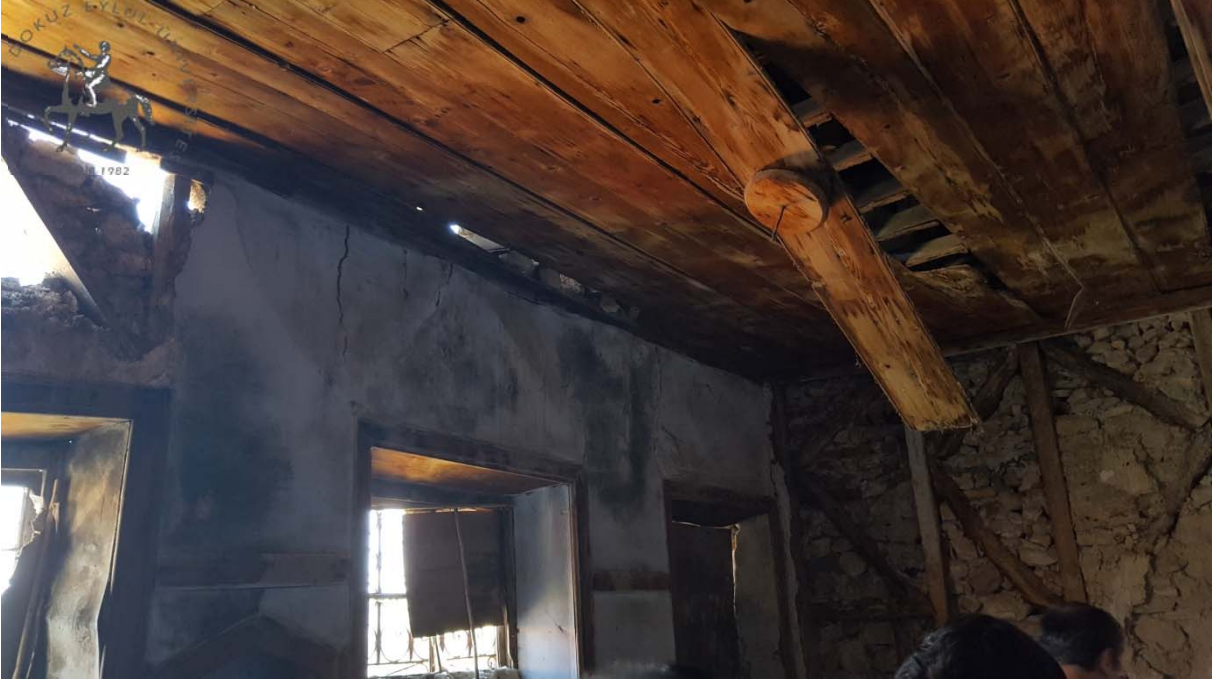
Foto 5. Kösedere köyünde eski yığma (kerpiç) yapının duvarında oluşan kısmi yıkılma ve çatlak ile tavadaki ahşap döşeme kirişinde oluşan ayrılmanın görünümü
