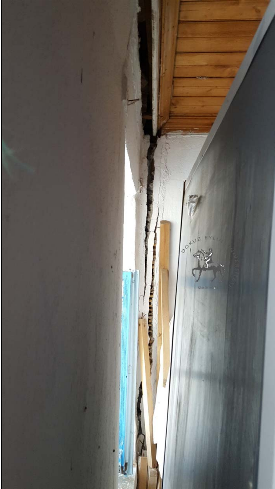
Foto 2: Bozköy'de iki katlı yığma (kerpiç) yapının üst kat odasının dış cepheye bakan köşesinde oluşan derin çatlak ve tavan kaplamasından ayrılma
