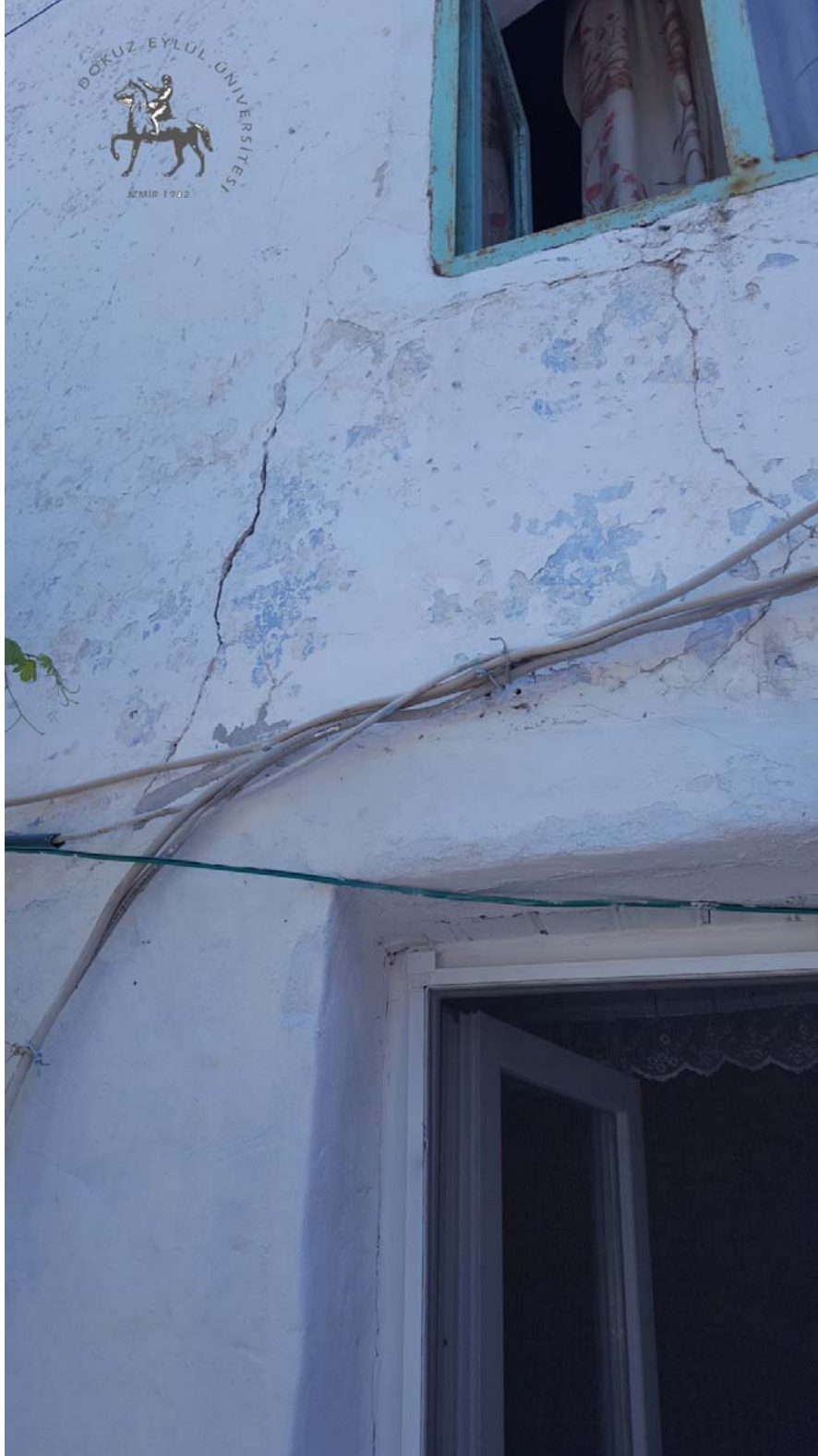
Foto 9. Kösedere'deki bir başka eski yığma (kerpiç) yapının dış cepesinde, üst kat pencere altında oluşan çatlağın görünümü
