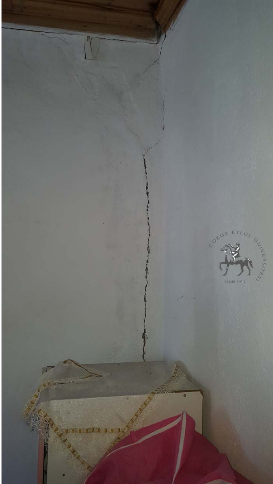
Foto 10. Kösedere'deki eski yığma (kerpiç) yapının üst katında, duvar yüzeyinde oluşan çatlağın görünümü
