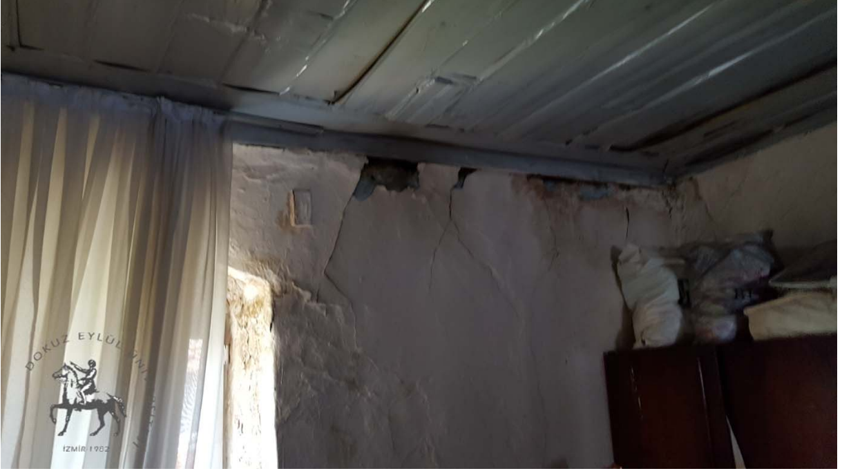
Foto 7. Kösedere'deki bir başka eski yığma (kerpiç) yapının üst kat dış cepheye bakan duvarında oluşan çatlağın görünümü
