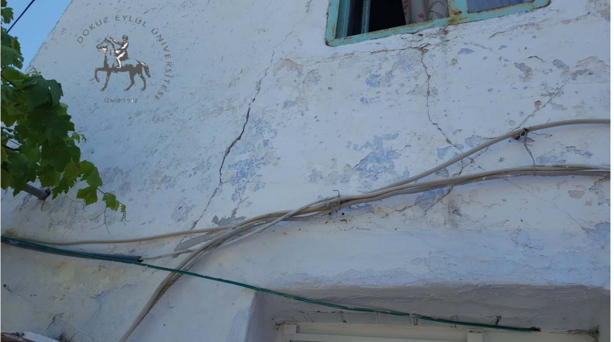
Foto 8. Kösedere'deki eski yığma (kerpiç) yapının dış cephesinde, üst kat pencere altında oluşan çatlağın görünümü
