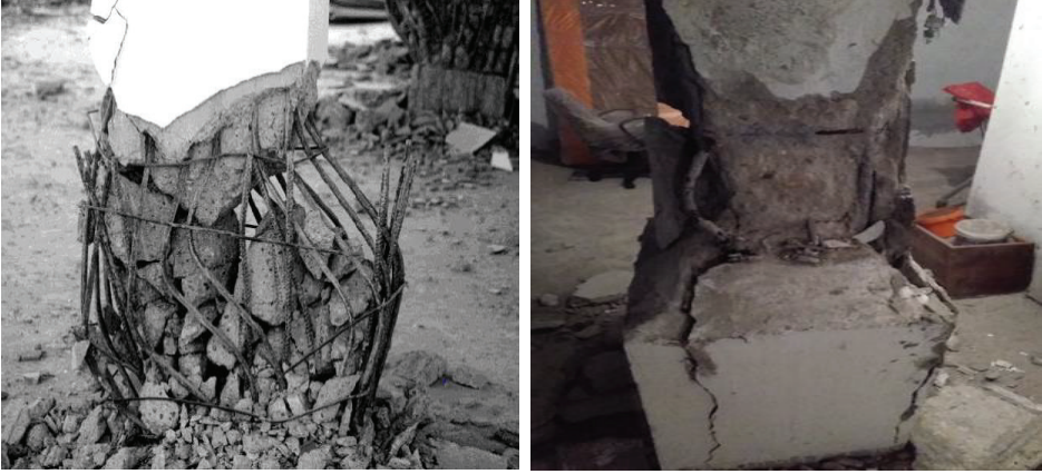
Resim 60. Yetersiz Sargılama, Korozyon, Donatı Burkulması
