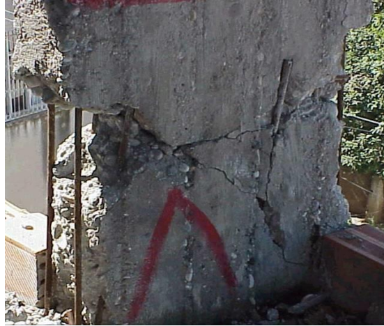
Şekil 20. Yeterli sıklıkta etriye kullanılmamış ve yetersiz işçilik nedeniyle oluşan kolon hasarları.
